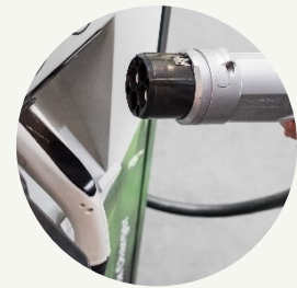
Pré-instalação para carregamento de veículos elétricos
